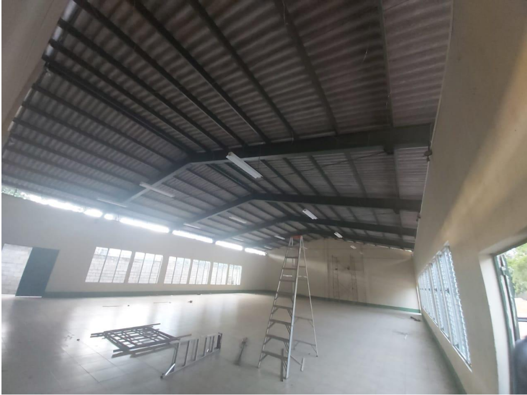
1. Estado actual del cielo del salón
